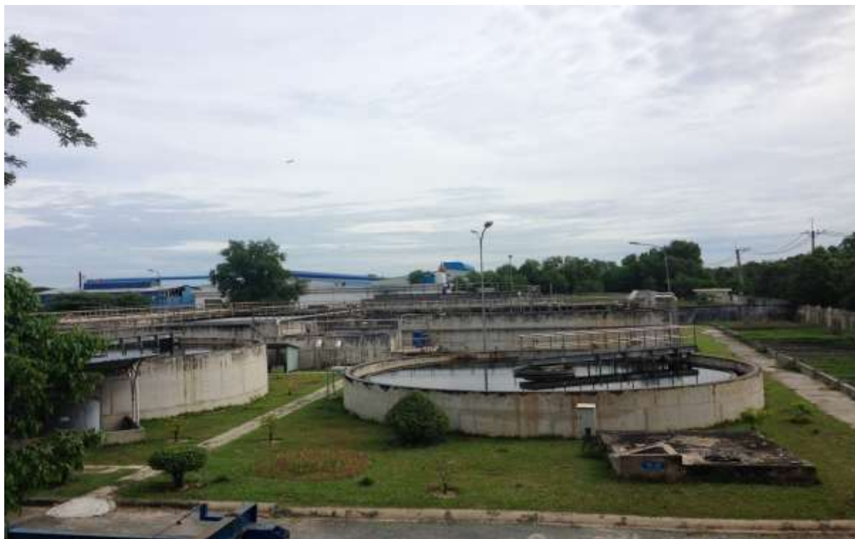
Hình 3. Nhà máy xử lý nước thải tập trung KCX&CN Linh Trung III
